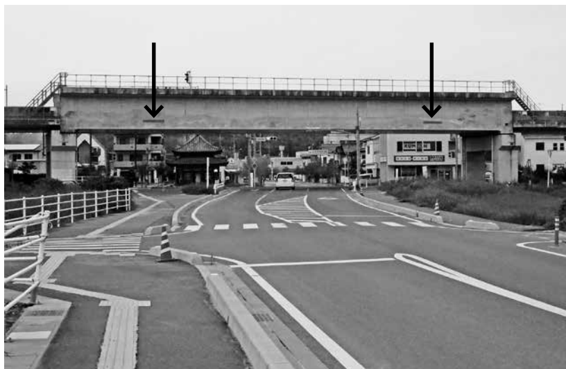
井原線の高架に記された横線＝2018年9月17日、倉敷市真備町箭田
